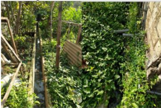
Gambar 1. Kondisi saluran air yang tidak terawat
